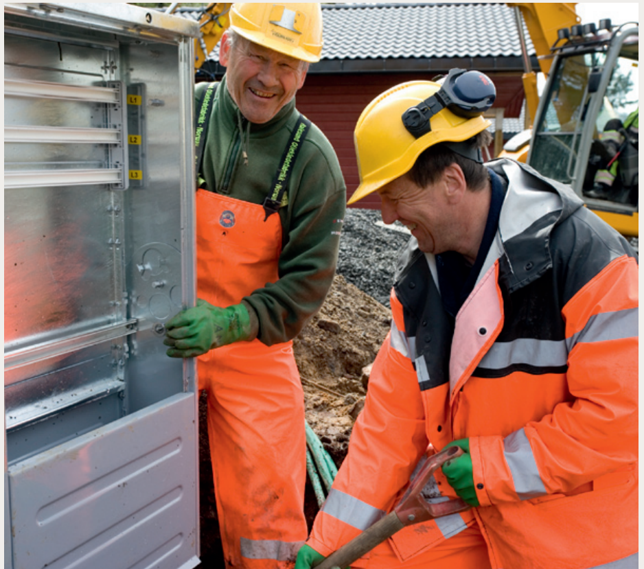
Asbjørn Nore (t.v.) og Arvid Verpeide i ferd med å legge kablar og sette opp EL-skap til Nore fjordsenter (campingsenter) på Bryggja. Foto: JK Foto, Raudeberg
